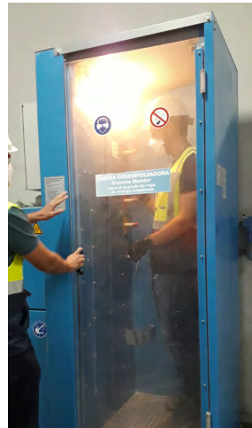
Fig. 6.1. Cabinas de limpieza de personal (Fuente: INS)
